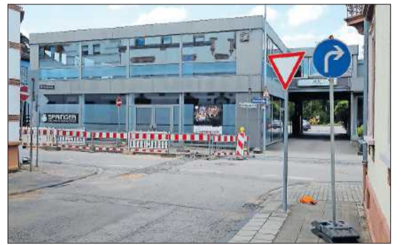
Für Autofahrer hoffnungslos: Links herum ist die Durchfahrt verboten, rechts herum ist die Baustelle – kein Durchkommen. FOTO: LABORENZ
